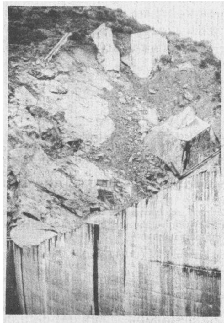
图 1-5 马尔巴赛拱坝失事后左坝头一瞥 不连续面切割成的楔形体的移动导致混凝土拱的破坏,其中一个不连续面形成坝头新露出的岩面
