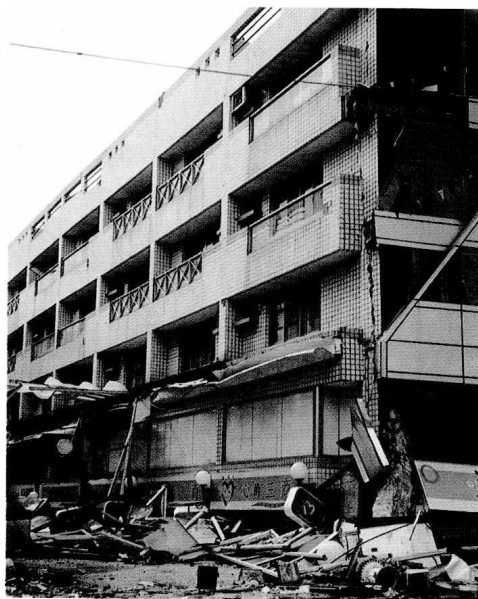
1階部分が完全につぶれたマンション（東勢地区）
