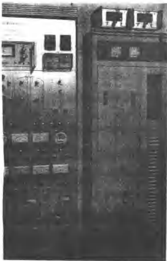
镀膜机电源控制、测量柜与偏压、辉光电源柜
