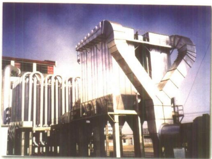
金光铁合金公司12500kVA硅铁炉 高温烟气治理及超细硅粉收集系统
