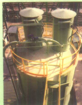
江苏芬欧汇川热电厂 气力输送系统料仓顶部设备
