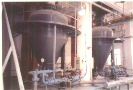
上海石化热电厂石灰石气力输送设备
