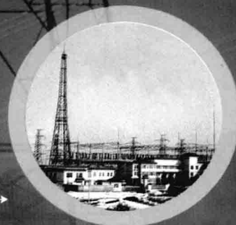
500千伏东善桥变电所
