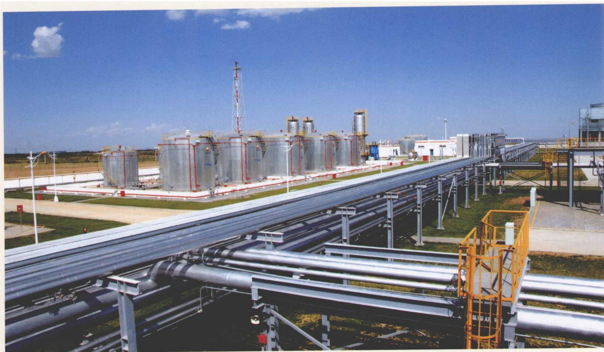
2008年，中国石油天然气集团公司全年销售天然气525.3亿立方米，同比增长15.9%。图为亚洲最大的天然气处理厂——苏里格第二天然气处理厂
