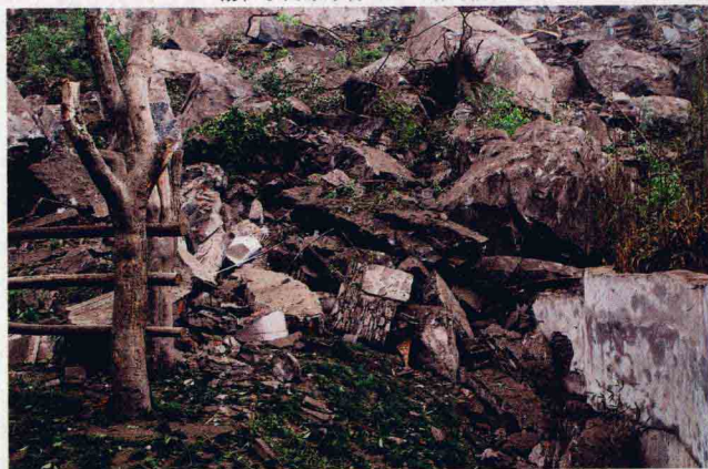
拟赠送给台湾的大熊猫团团、圆圆的圈舍破损严重，运动场只剩下角上一个供熊猫玩耍的木架
