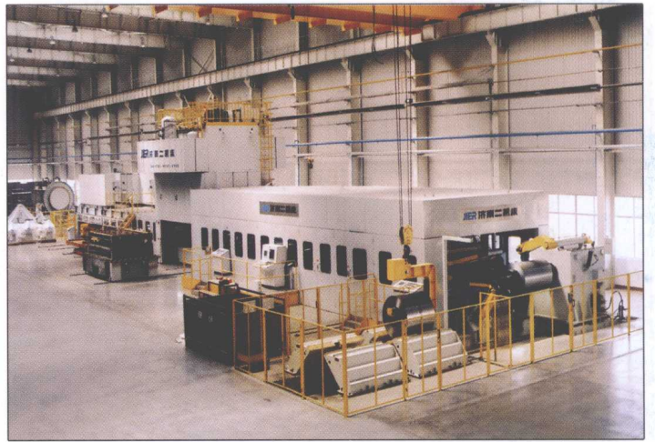
● 由1台J39C—500A型闭式四点单动落料压力机和开卷、校平、送料、磁性码垛等自动化装置组成的ZSK—3×1850开卷校平落料自动线（安装在长城汽车股份有限公司）
