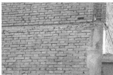
(c) 施工成型的圈梁混凝土质量很差
