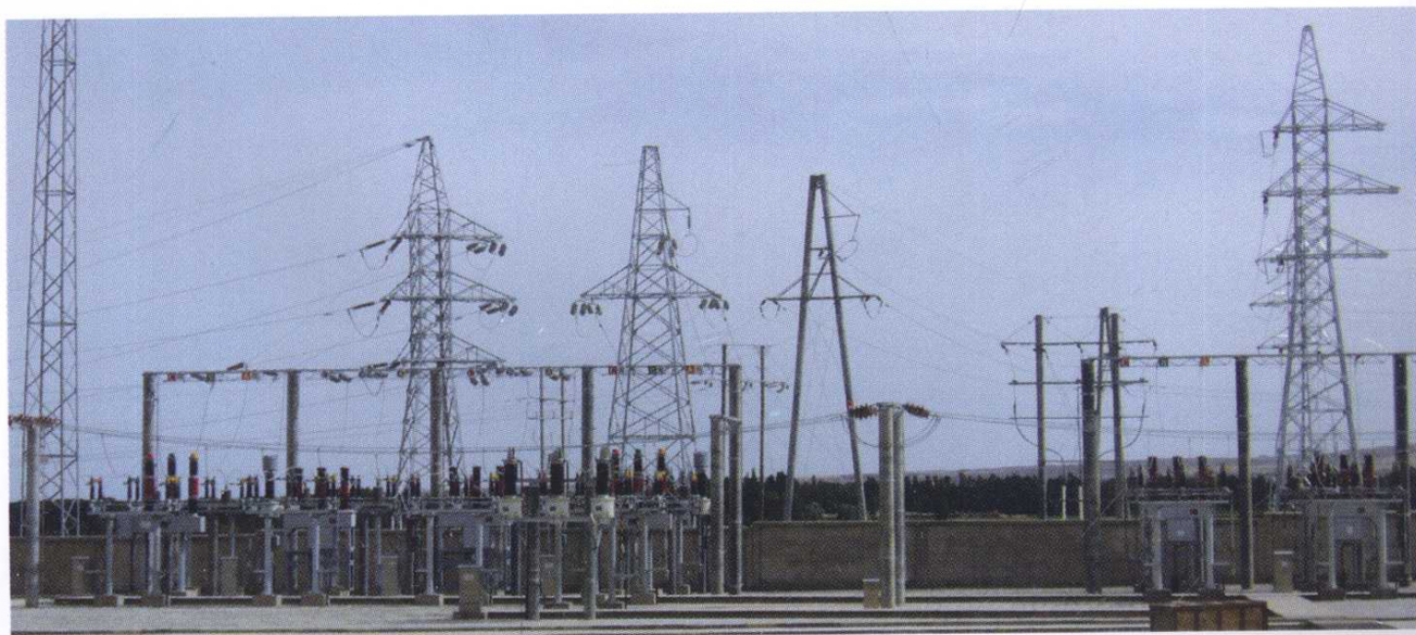
党城 110 千伏变电站
