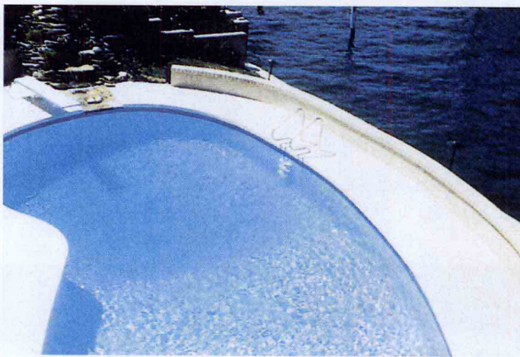
图 10 游泳池采用白色水泥灰浆饰面可以改善水的美感和增加安全性
