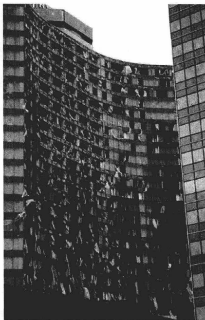
图 1.3 玻璃幕墙在飓风作用下严重受损
