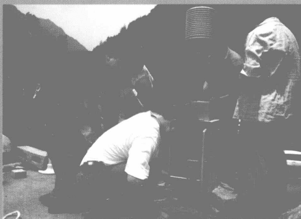
6月21日19时30分，重庆市巫溪县中梁乡发生岩体垮塌，造成河道堵塞，危及下游三万多人的生命财产安全。图为气象技术装备人员正在距垮塌现场200米处紧张安装自动气象站。（单丽静 摄）
