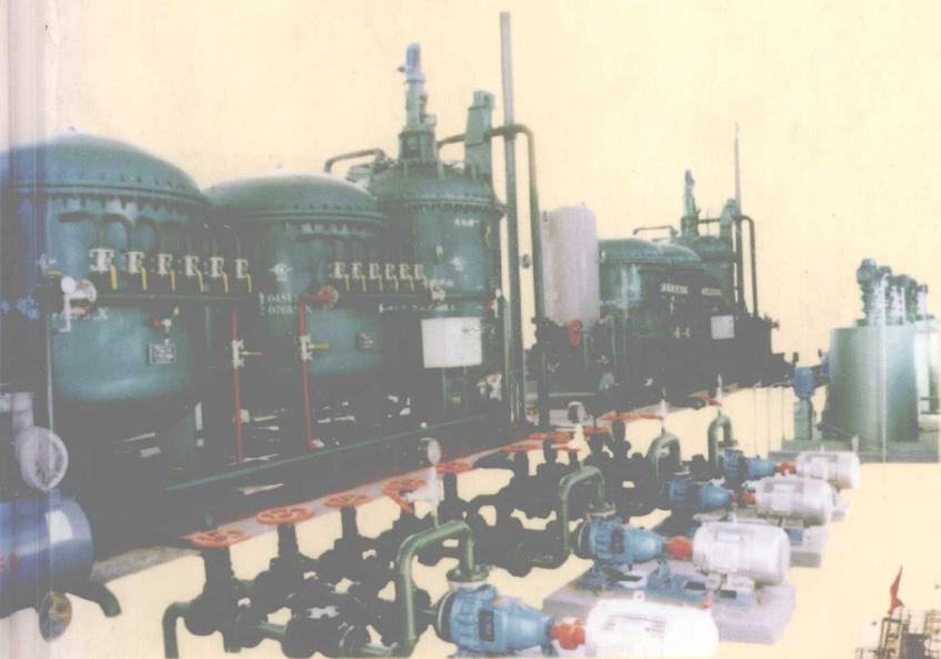
定边采油厂污水处理系统
