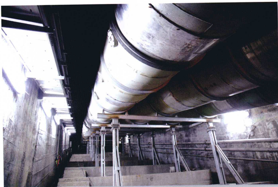
2009年6月瀑布沟6号机组主变封闭母线（梁江 摄）
