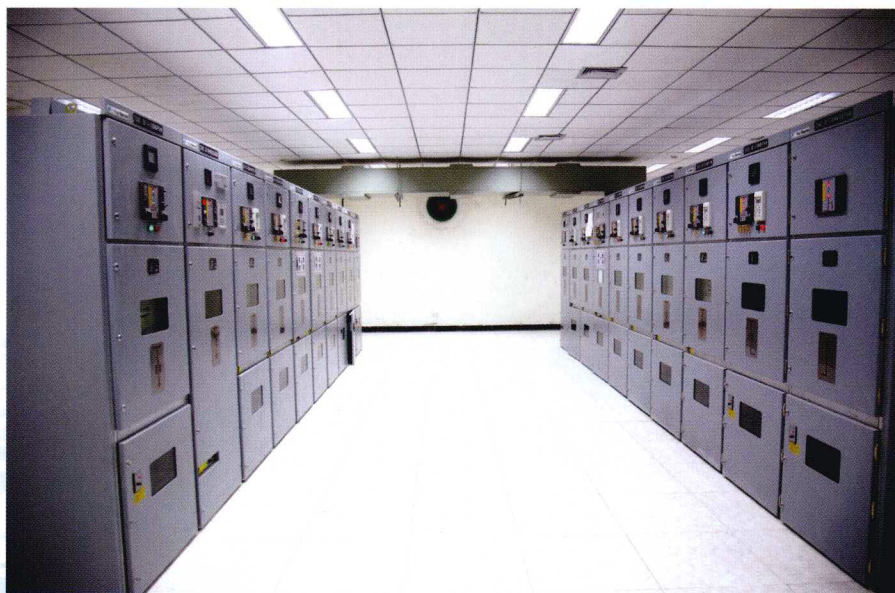
2009年5月副厂房10kV室公用电系统（梁江 摄）
