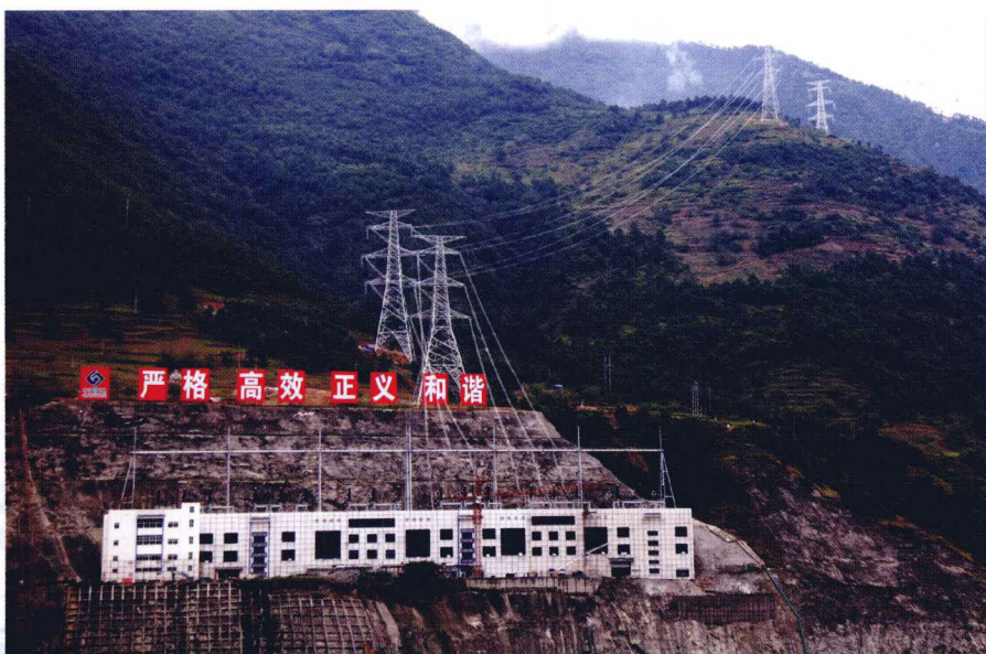
2009年10月开关站全貌（梁江 摄）
