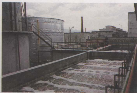
横店有机化工集团废水处理系统
