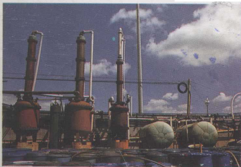
横店有机化工 集团废料回收塔
