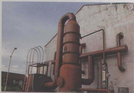
横店康裕集团氯丙酮吸收装置
