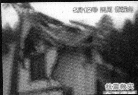
房子一瞬间被震塌了。
