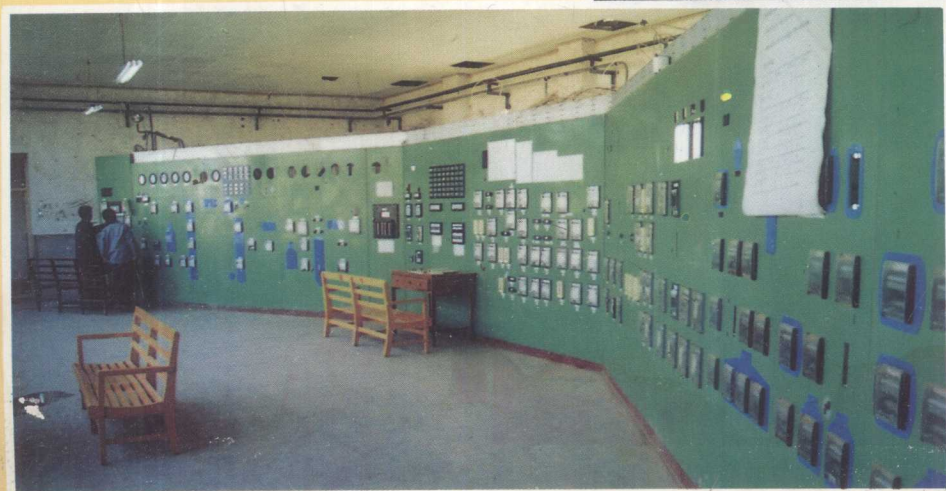
延安炼油厂总控制室
