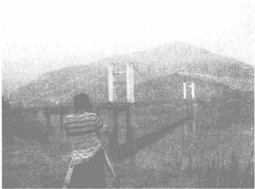
图 1-5 南盘江大桥旧桥鉴定
