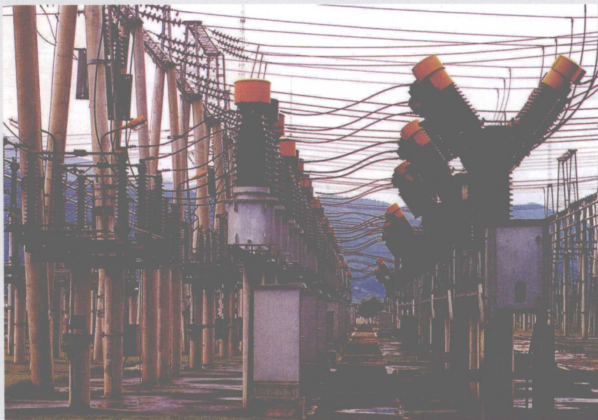
▲ 高新区变电站
