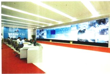
刘庄煤矿调度集控中心
