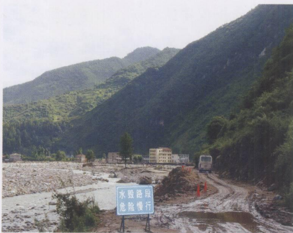
陕西佛坪境内被山洪冲毁的公路（马东涛摄）
