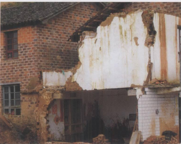
湖南郴州被山洪冲毁的房屋（张平仓摄）
