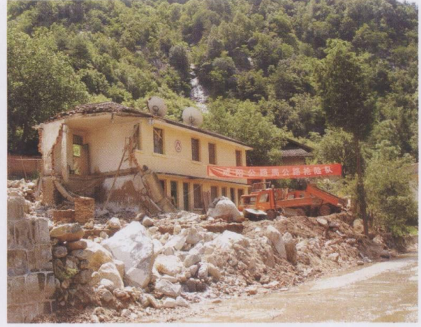
陕西佛坪被泥石流冲毁的公路道班（马东涛摄）
