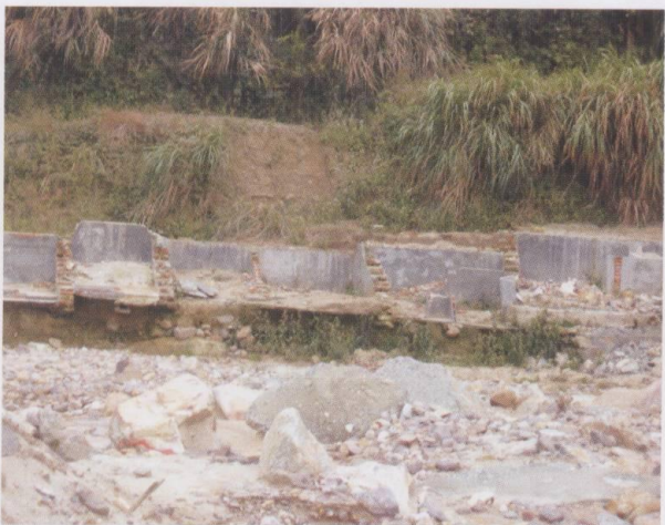
被山洪冲毁房屋（张平仓摄）
