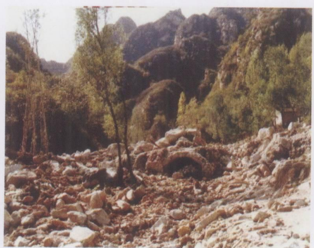
北京延庆松树沟被山洪泥石流冲毁的公路和桥梁（谢洪摄）
