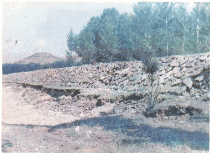
沿河乱采砂石造成堤坝护坡被破坏现场
