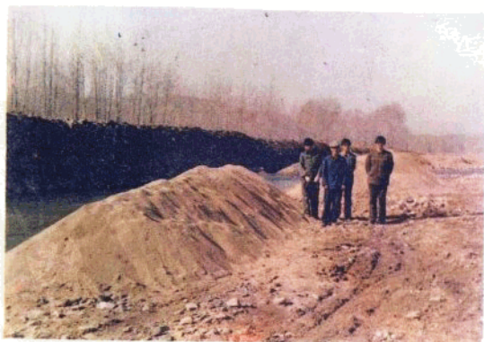
沿堤乱采砂形成串沟险工现场
