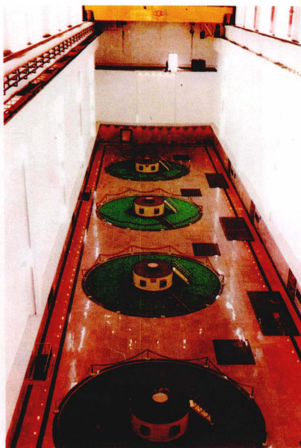
天生桥二级电站厂房发电机层
