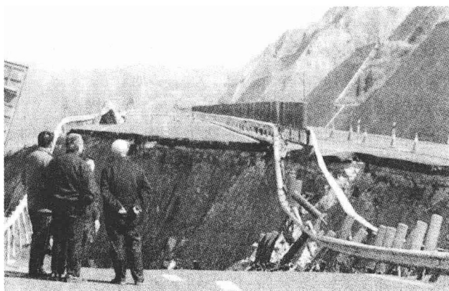
图 1.3 太旧高速公路垮塌图
