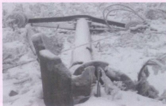
不堪凝冻重负倒塌的电线杆
