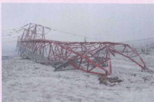
倒塌的输电线铁塔
