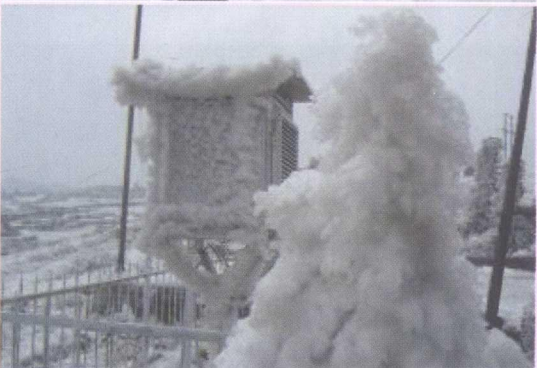
气象观测设备被冰雪覆盖
