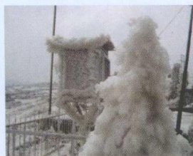
损坏的百叶箱
