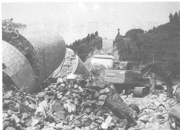
图1 湖南省凤凰县“08.13”大桥坍塌事故现场（一）
