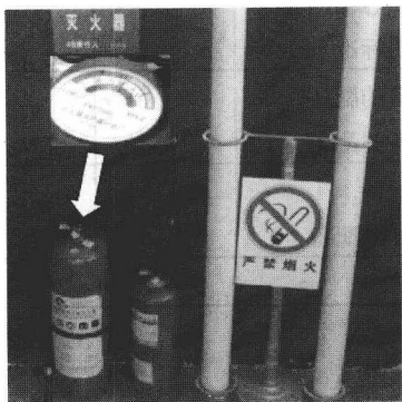
图 1-11 消防设施性能良好
