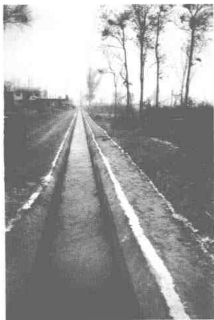
灌溉渠道正在运行
