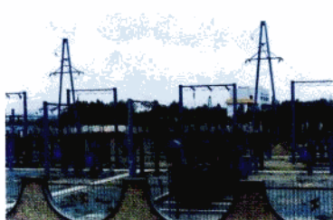
大河家电站升压站
