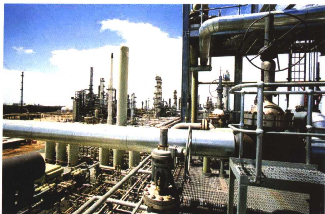
图1 天然气水蒸气重整制氢工厂（英国）
