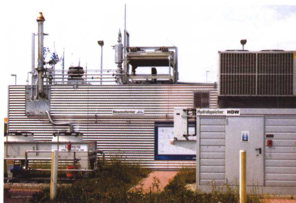
图2 位于慕尼黑机场加氢站的天然气部分氧化重整制氢装置
