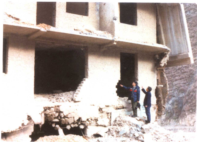
照片 2.2 泥石流冲毁楼房(四川南坪县)
