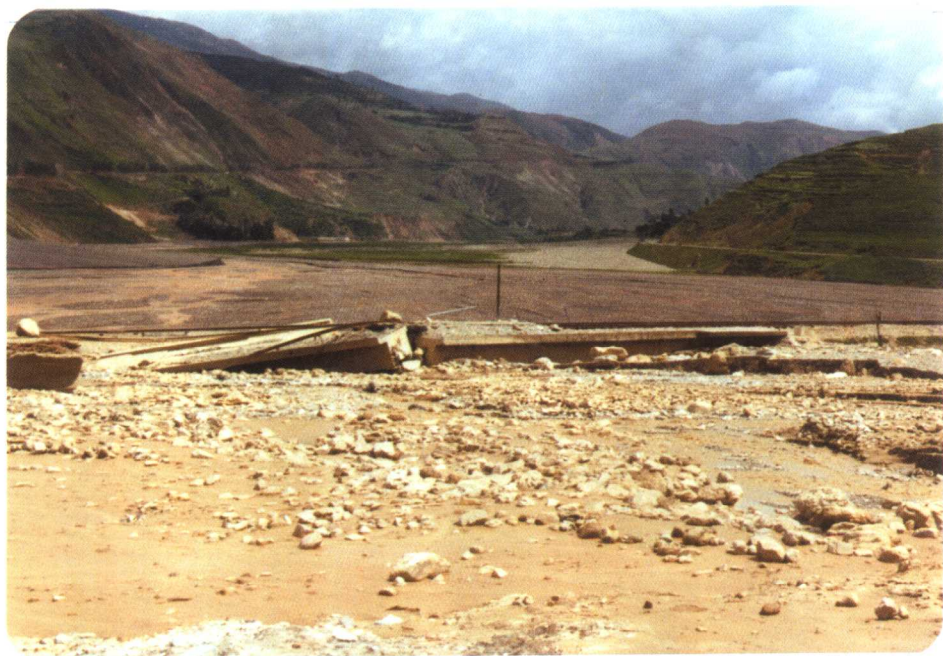
照片 2.5 泥石流冲毁铁路桥
