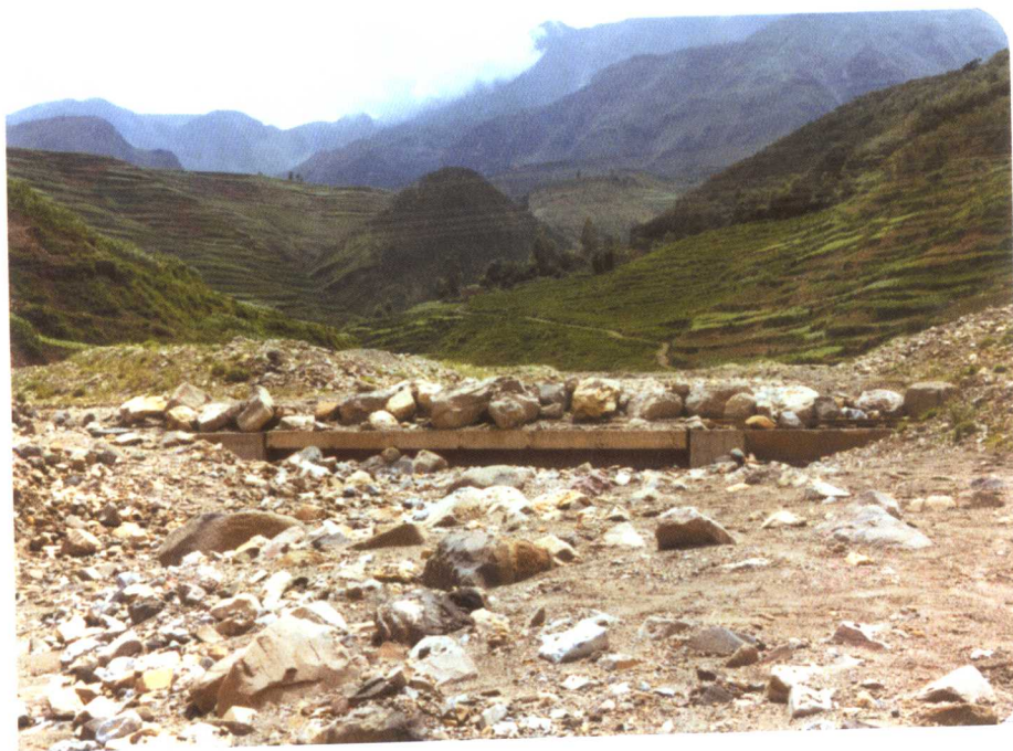
照片 2.4 泥石流淤埋铁路桥
