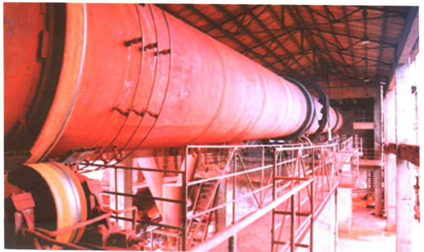
彩图 15 钢锌示范工 程的焙解工序场景
