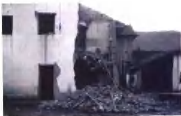
1995年1月24日寻乌 M_L 4.5级地震时，被震坏的吉潭镇水电站的房屋。
