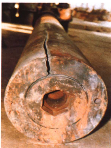
图2 厚壁容器脆性断裂外观
