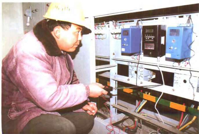
江都市供电局自行研制生产的低 压电力负荷控制器（图中黑色仪表）
