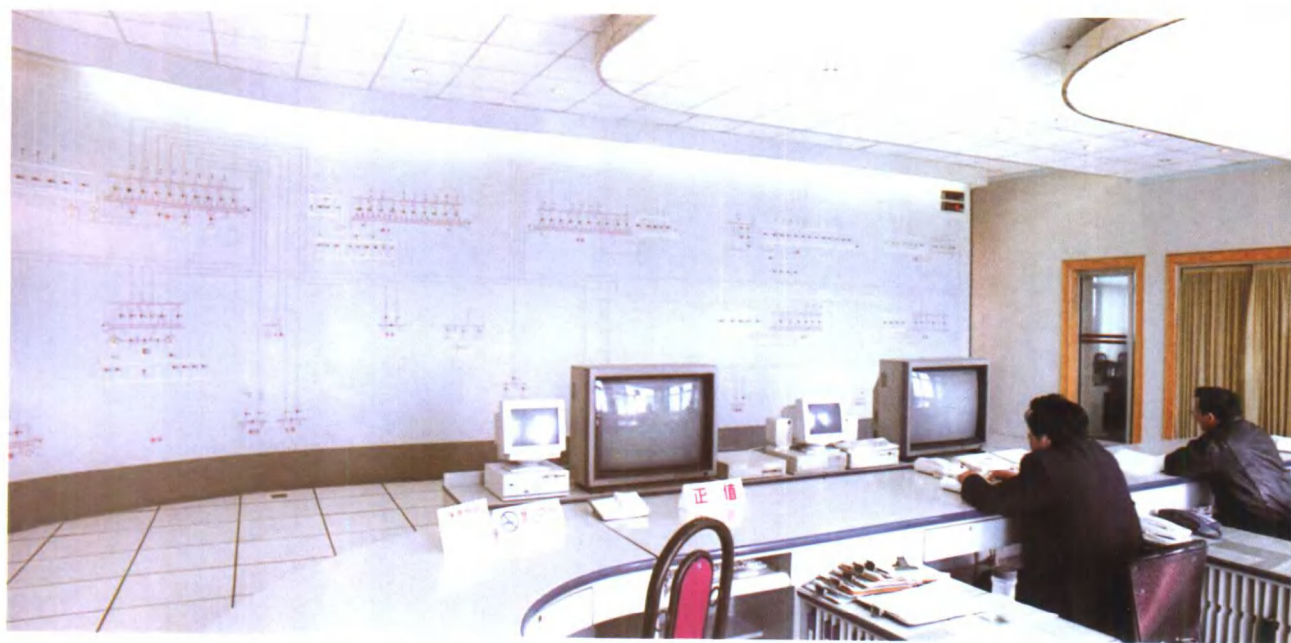
扬州供电局电网调度中心
