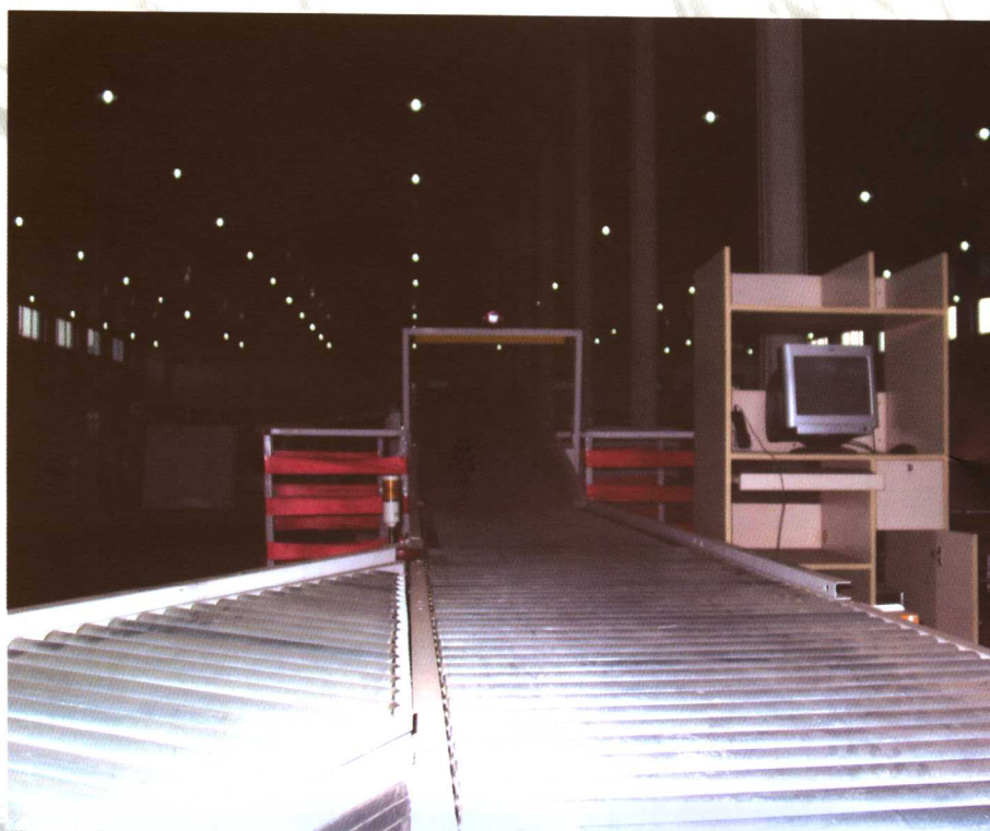
顺义空港物流基地内物流中心分拣线
