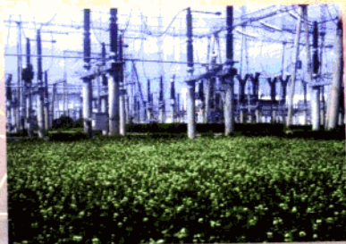
图为马青220KV变电站
