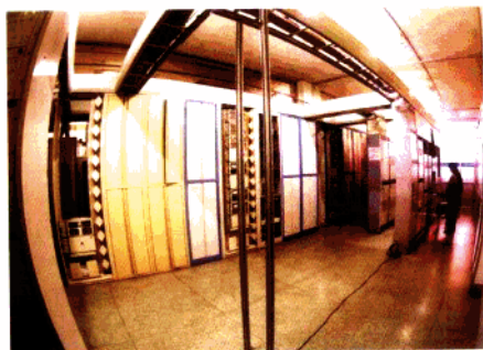
现代化的通信机房
