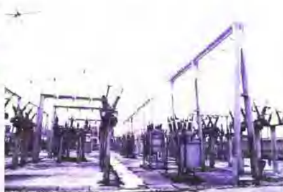
煤矸石电厂 35kV 升压站
