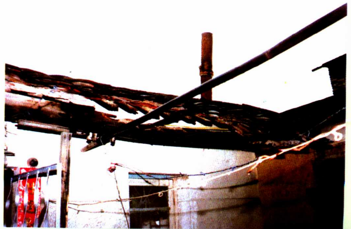
厦门罐头厂(电台山5栋)屋檐震塌、掉瓦
