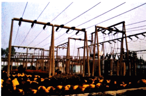
110 千伏变电站一角
