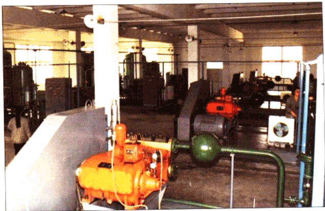
樂安油田目前最大的注汽站——9號注汽站一角
