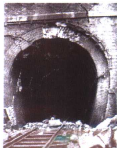
台湾省山线铁路后里与大安火车站同第8号隧道严重受损，屯仔脚地震断层穿越此隧道
