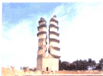
山西曲沃感应寺震裂
