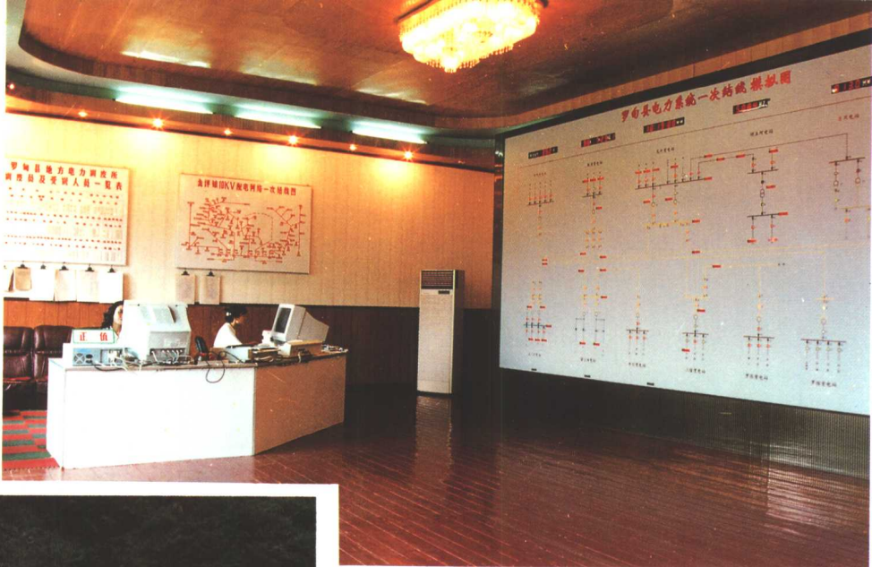
罗甸县电网调度自动化。
