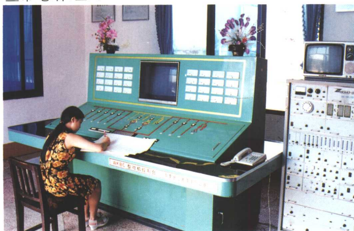
瓮安草塘 35KV 四合一变电站集控台。
