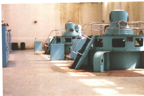
铜仁漾头水电站机组。
