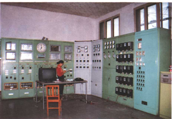
施秉城关变电站值班室。
