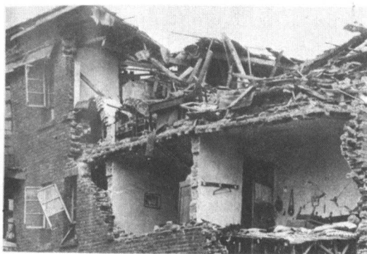
楼房墙倒顶塌
