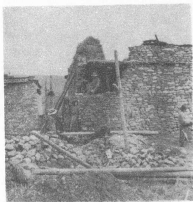
20. 扎亚木架房石砌围护墙全裂缝， 局部垮塌。 李介成摄
