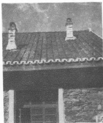
22. 新都桥国营食堂烟囱与房顶接触处 震脱。 镜向：北。 李介成摄
