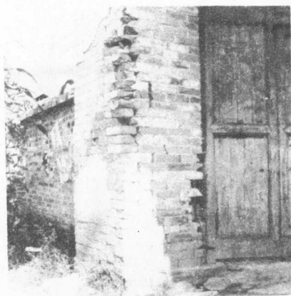
15. 马边县城关区房屋砖柱破坏情况。
