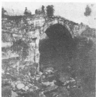
5. 双流县三星公社苦潭队附近 石拱桥栏部份震垮。
