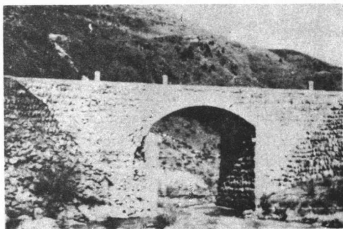
32. 雄鸡岭红旗桥桥身和桥面开裂，护坡震垮。 邓天冈摄
