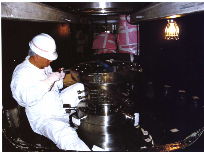
一回路主泵大修检查
