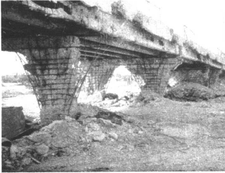
图 1.3 某桥梁钢筋锈蚀破坏
