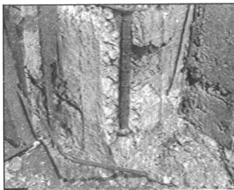
图 1.2 某矿厂房柱钢筋锈蚀破坏
