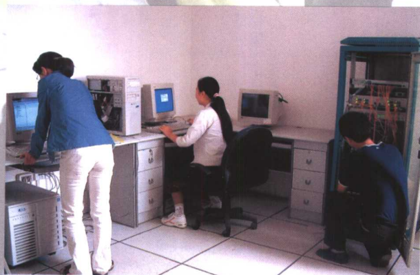
网络中心机房
