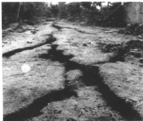
唐山大地震中裂开了的地面
